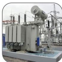
Объекты энергетической отрасли
